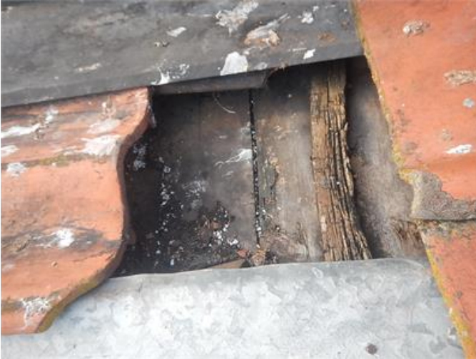
Del av tak där takpanna glidit ner pga. rötskadad läkt och att takpapp saknas.
