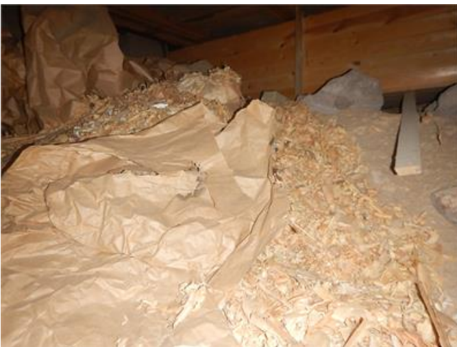
Vy över krypgrundsdelen med organiskt material på markytan.
