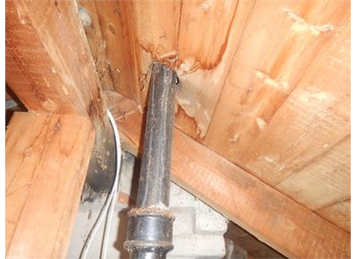
Fuktgenomslag på underlagstak vind.
