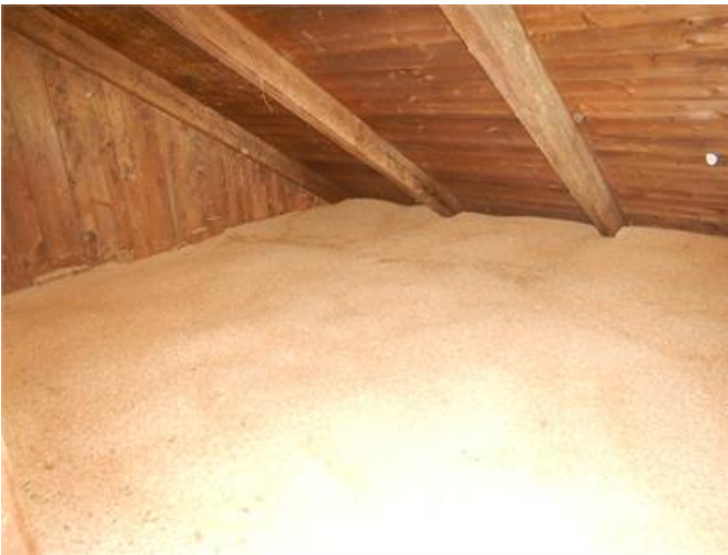
Mikrobiell påväxt på underlagstak samt gavelspets vind.
