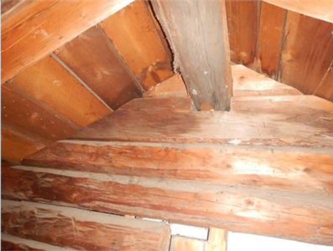
Fuktfläckar på underlagstak vind.
