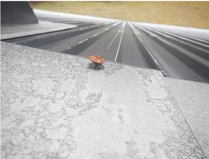
Plåtspik som krupit ur takplåt.
