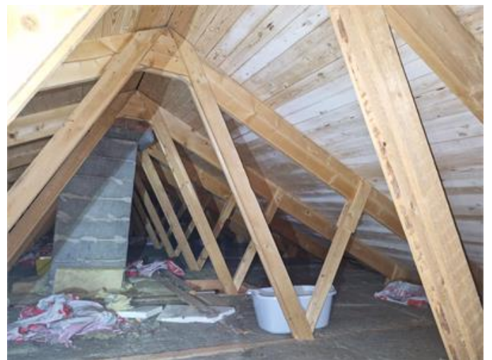
Nockvind övredel, mikrobiell påväxt i underlagstaket.
