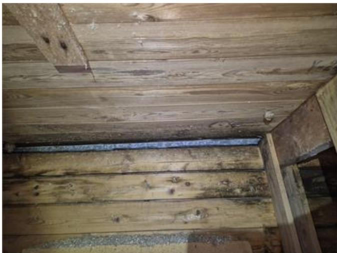
Mikrobiell påväxt på vind
