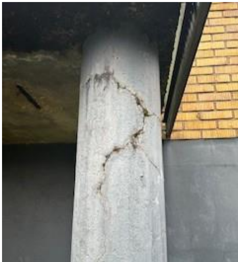
Sprickor i balkongpelare
