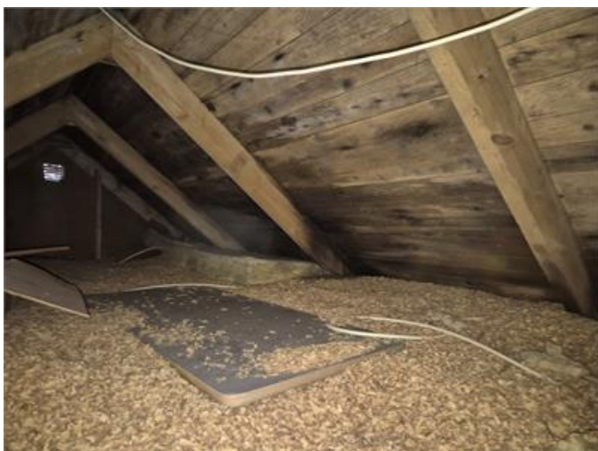
Mikrobiella tillväxter på takkonstruktion på vind.
