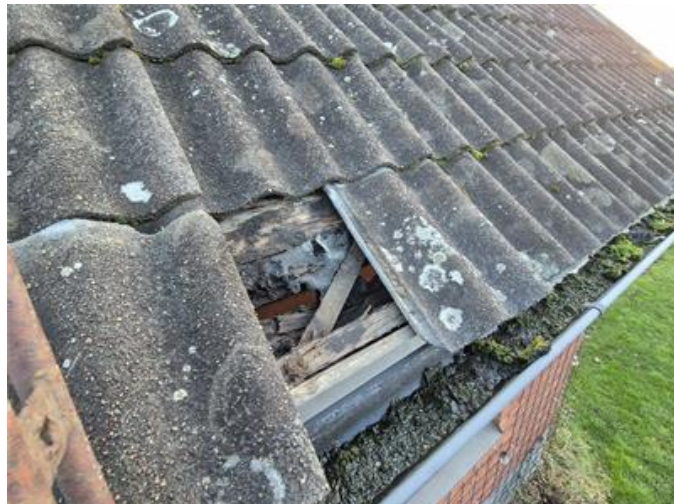
Rötskada i takkonstruktion.
