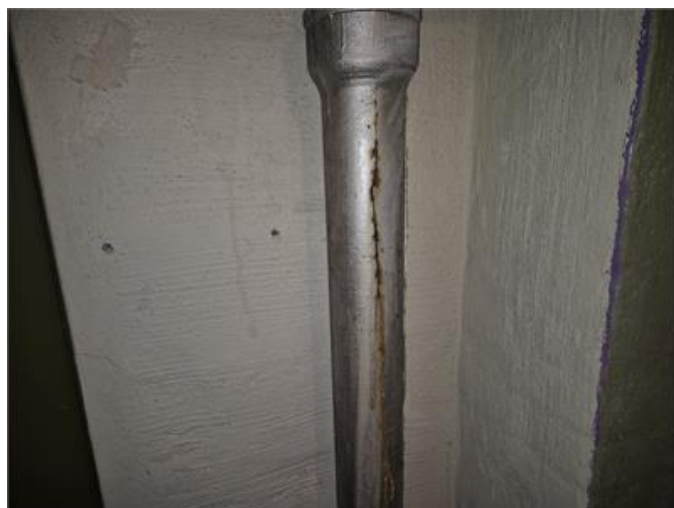
Spricka i avloppsstam i källare.
