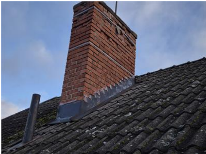
Skador förekommer i skorsten.
