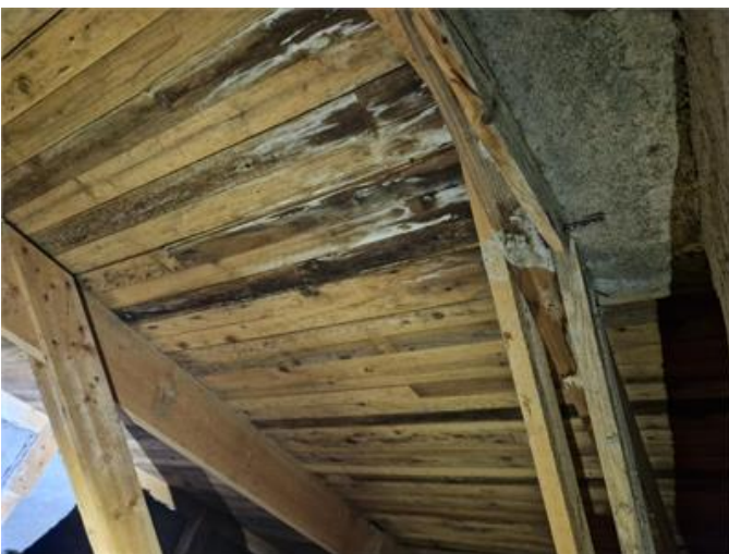
Lokala fuktfläckar på vindsutrymmet
