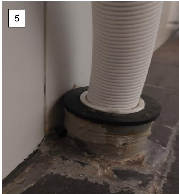
Spillvattenledning för nära vägg.
