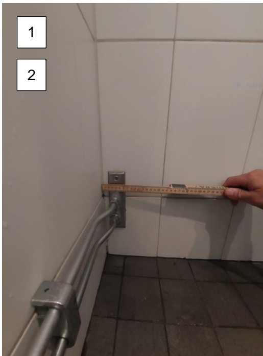
Rör genomföring i duschzon, samt nära vägg.
