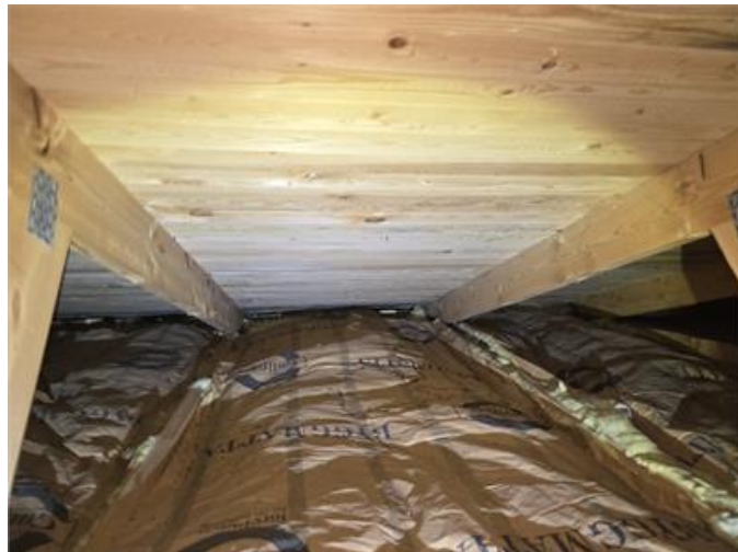
Mikrobiell påväxt nockvind, lokalt tät takfot.
