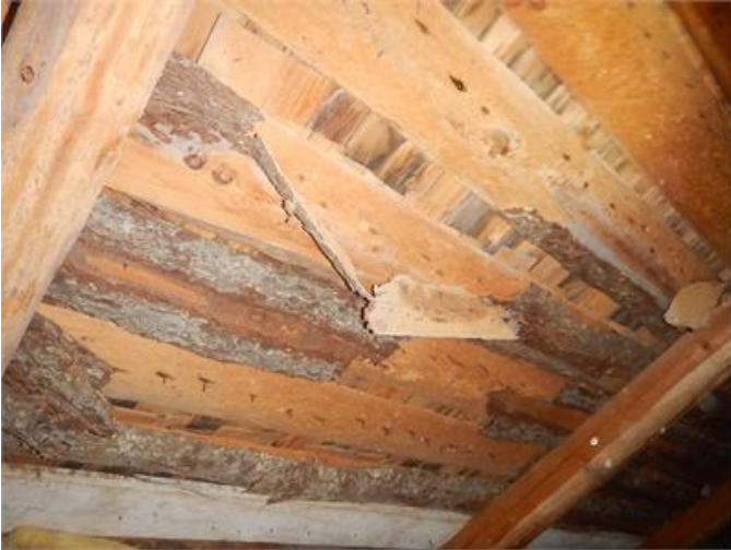
Insektsangrepp på underlagstak vind.
