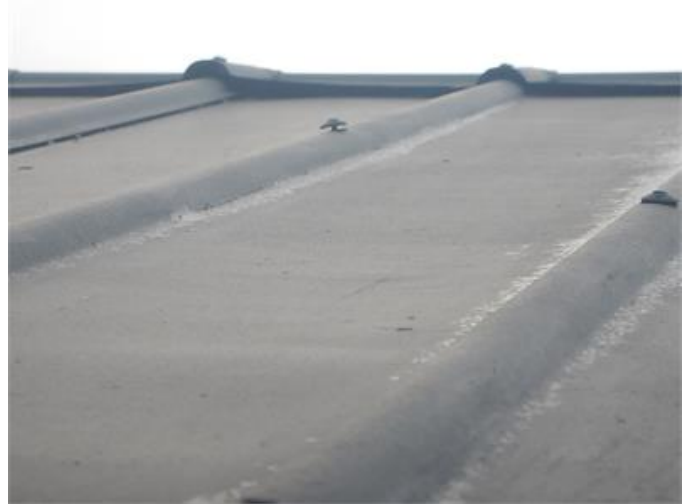
Plåtspik som krupit ur takplåt.
