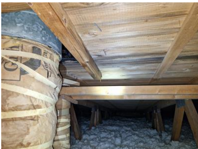
Nockvind, fuktskada med förhöjda värden vid ventilationsgenomföring.
