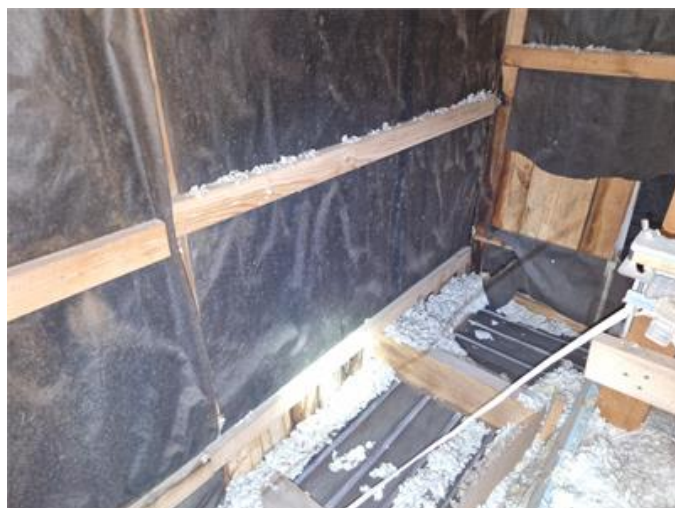
Nockvind, flera fuktskada taksargsbrädor finns.
