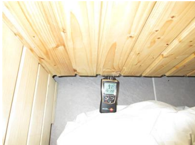
Fuktmätning i bastupanel (9,1% FK).
