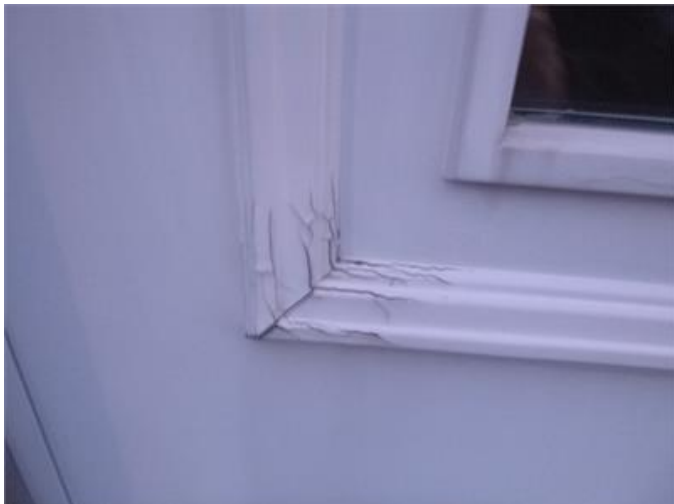
Bilden visar exempel på formförändringar i entrédörren till tvättstugan.
