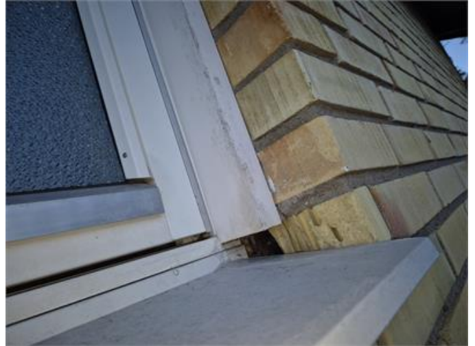
Otättheter vid fönster.
