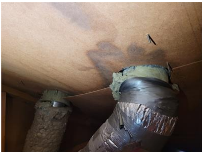
Fuktfläck på underlagstak.
