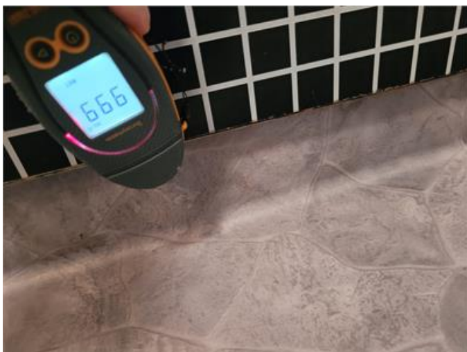
Fuktindikering i dusch på övre plan
