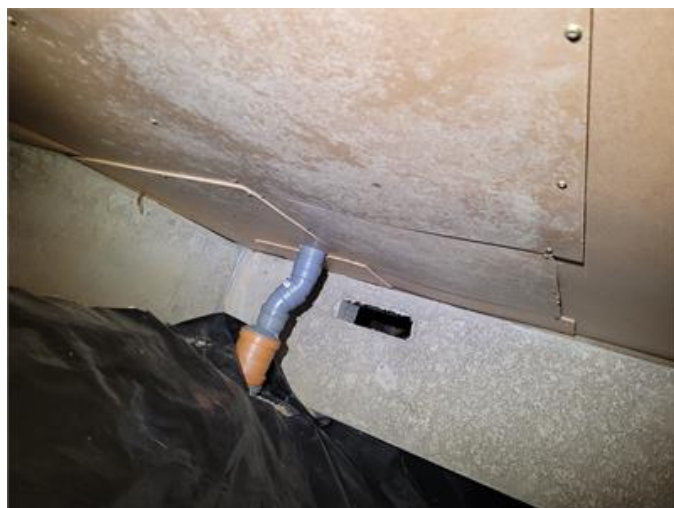
Mikrobiell påväxt på blindbotten i krypgrund
