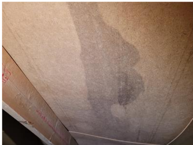
Fuktfläck på underlagstak.
