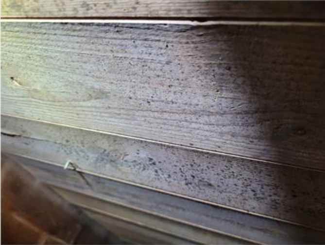
Mikrobiell påväxt på underlagstak
