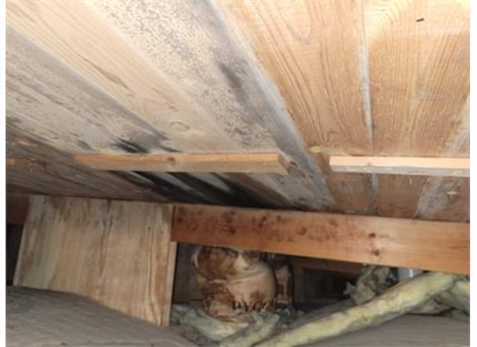
Fuktfläck på underlagstak
