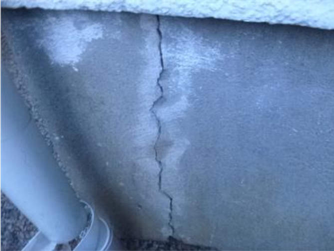
Bilden visar exempel på spricka i sockeln.
