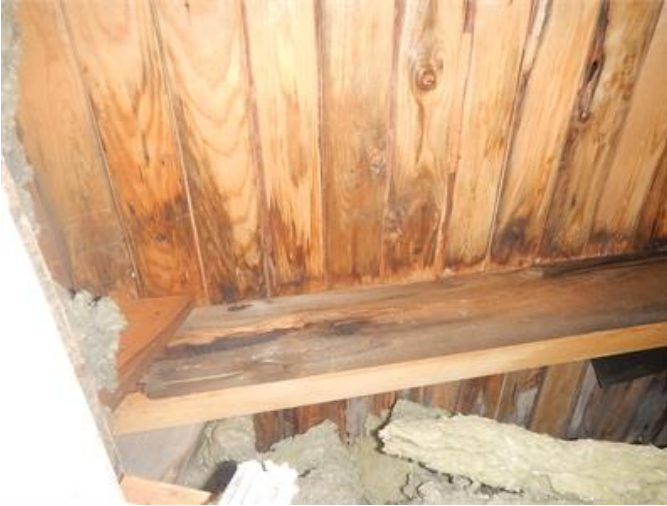
Fuktpåverkan och mikrobiell påväxt på underlagstak ovan vindslucka.
