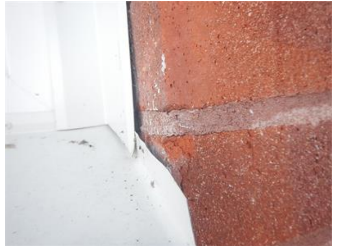
Fönsterbleck som är otätt mot fönster.
