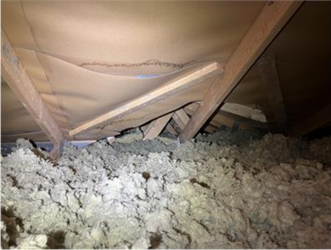
Bild visar delar av vinden där fuktfläckar finns på underlagstaket.
