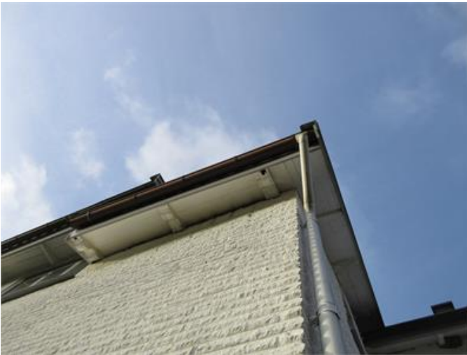
Röta i två utstickande takstolar i taksims
