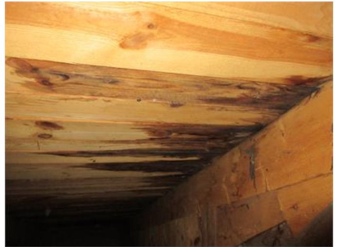
Missfärgning insida yttertak i vind
