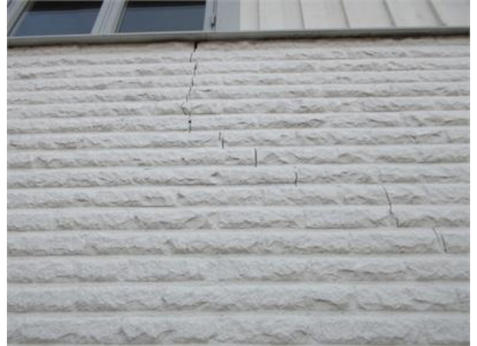
Exempel på spricka i tegelfasad
