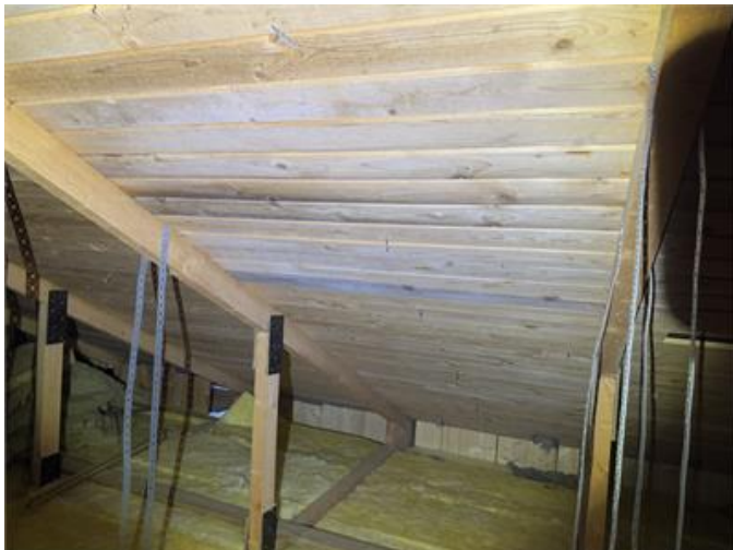
Begränsad mikrobiell påväxt på vindens underlagstak.
