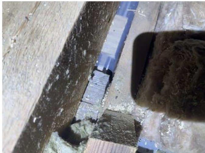
Otättheter i vindsbjälklaget samt bristfälligt isolerat vindsbjälklag.
