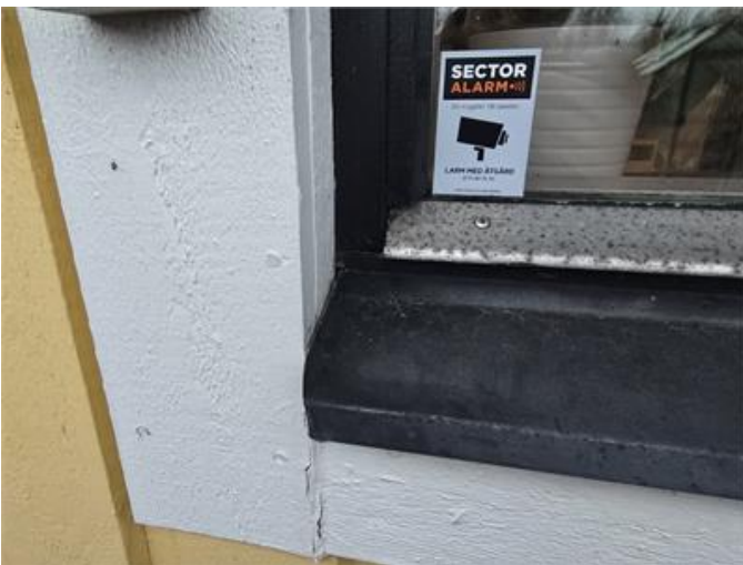
Exempelbild, otätheter kring fönsterbleck.
