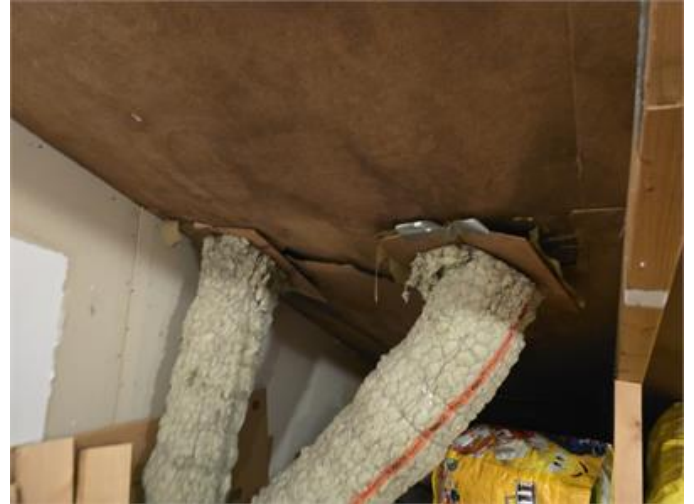
Exempelbild, fuktfläckar underlagstak, vind.
