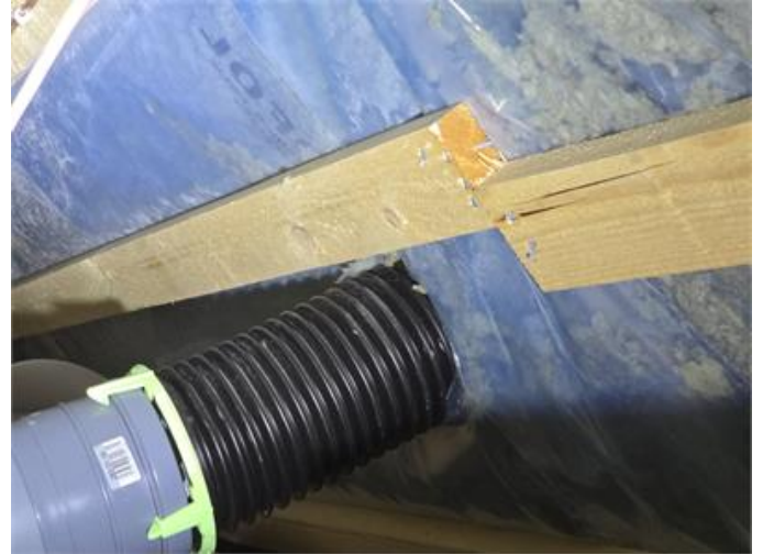
Exempelbild, otätheter i ångspärr kring genomföring.
