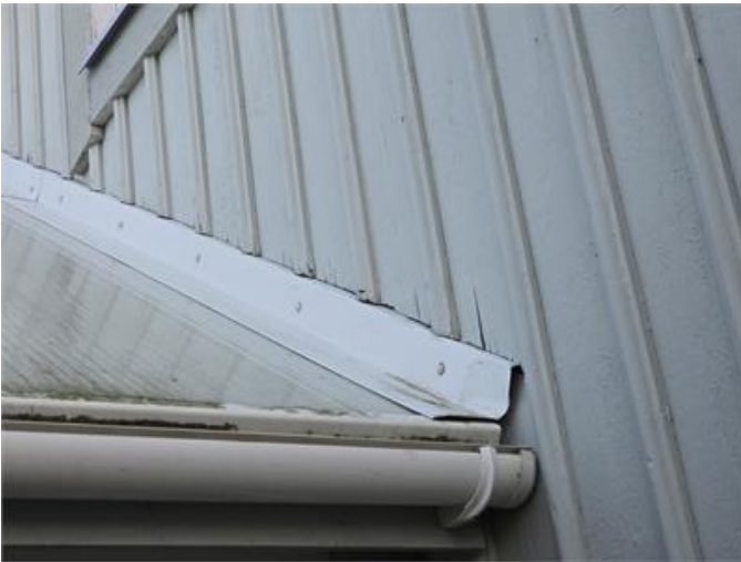
Exempelbild, begynnande rötskador och målning/underhållsbehov fasad.
