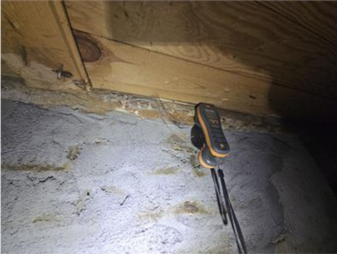
Exempelbild, fuktfläck i underlagstak med förhöjda värden vid indikation.
