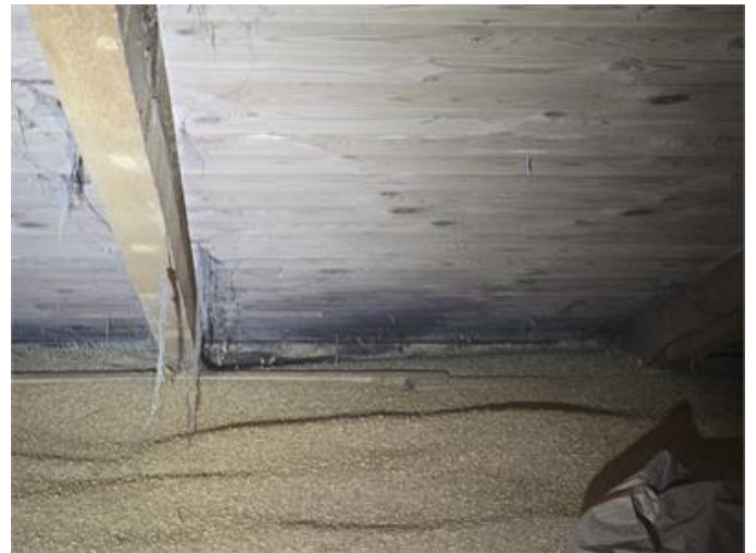
Exempelbild, mikrobiell påväxt underlagstak.
