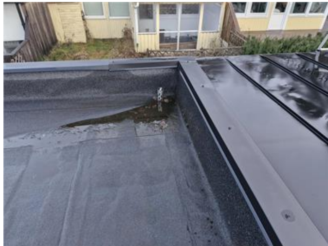
Tak, stående vatten vid inbyggt stuprör/brunn.
