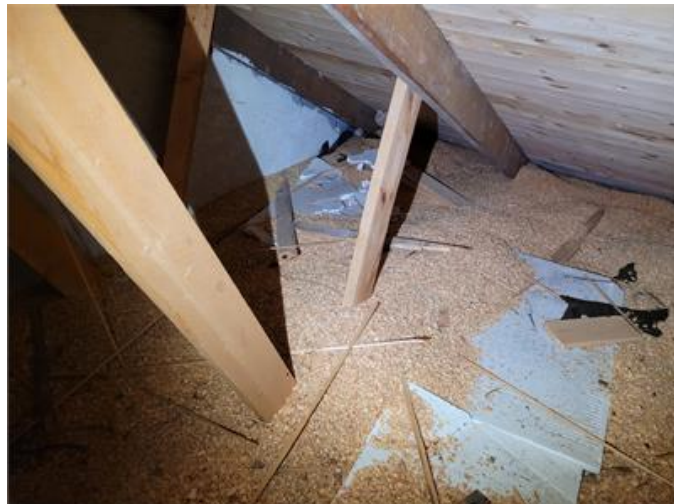
Vindsbjälklag bör städas av.
