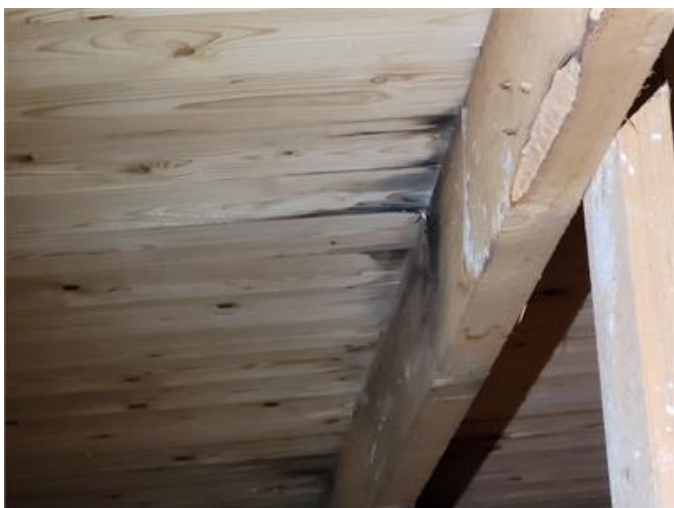
Fuktfläckar på underlagstak.
