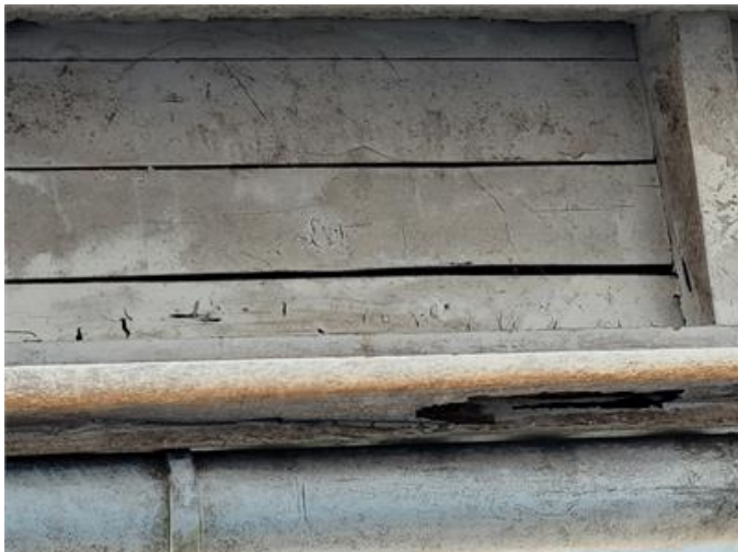
Rötskador i takfot.
