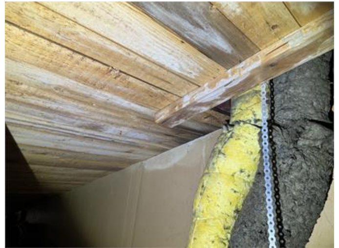
Missfärgningar/mikrobiell påväxt på vindens underlagstak.
