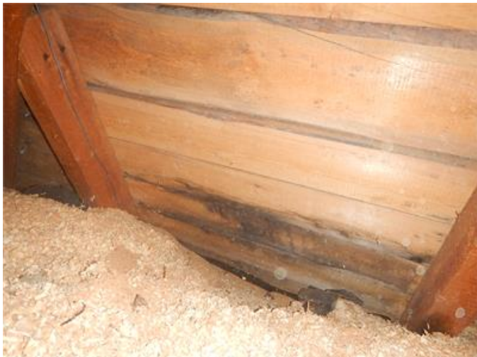
Mikrobiell påväxt på underlagstak vind.
