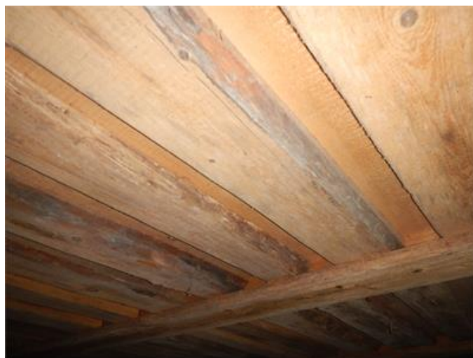
Mikrobiell påväxt på underlagstak krypgrund.
