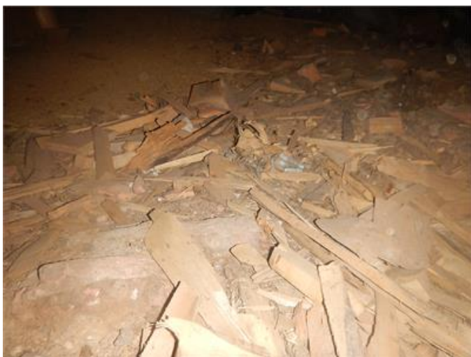
Organiskt material på markytan i krypgrund.
