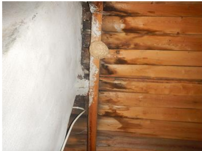
Fuktfläckar på underlagstak vind.
