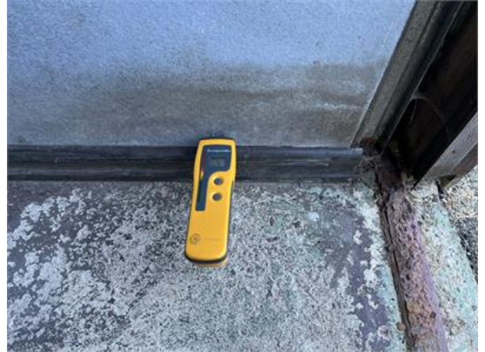
Förhöjda fuktvärden i nederkant vägg i garagebyggnaden.
