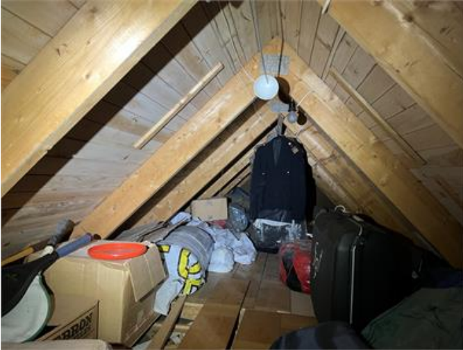
Mikrobiell påväxt på vinden.
