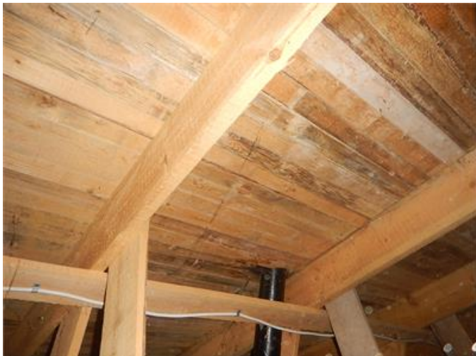
Mikrobiell påväxt på underlagstak vind.
