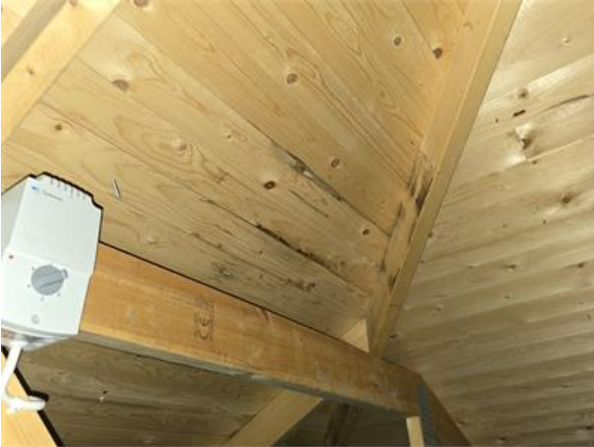
Fuktfläck/missfärgning Nockvind Norr.
