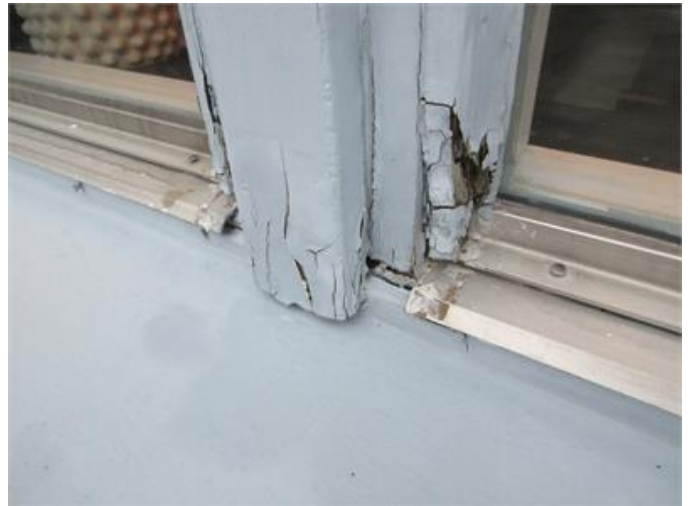
Rötskada i fönster
