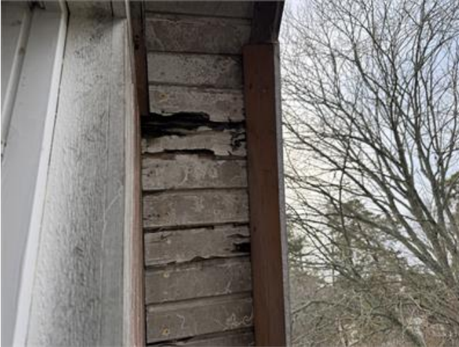
Takläckage vid takutsprång.
