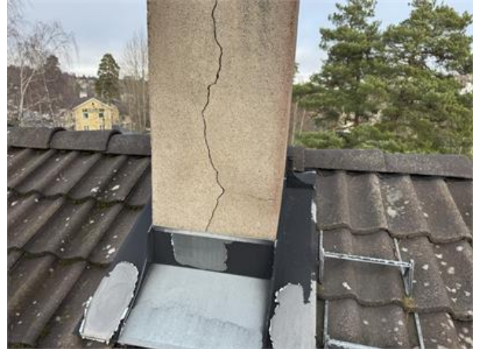
Bild visar sprickor i skorsten och färgsläpp på plåtbeslag.
