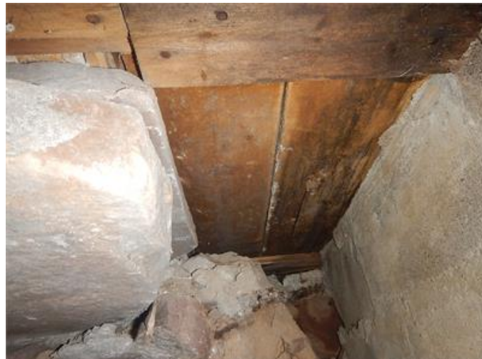
Mikrobiell påväxt/rötskada på blindbotten krypgrund/källardel.
