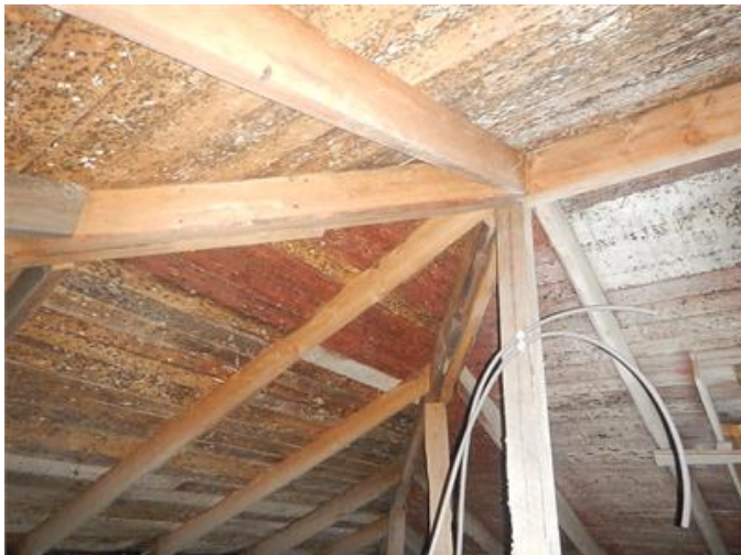
Mikrobiell påväxt på underlagstak vind.
