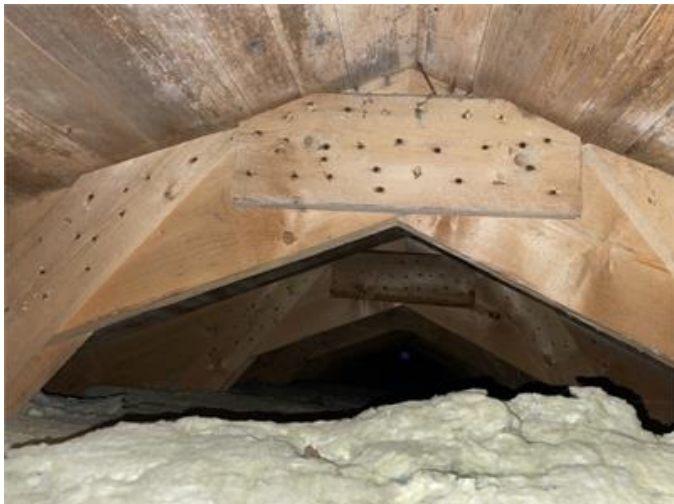
Vind övre del med gammal mikrobiell påväxt
