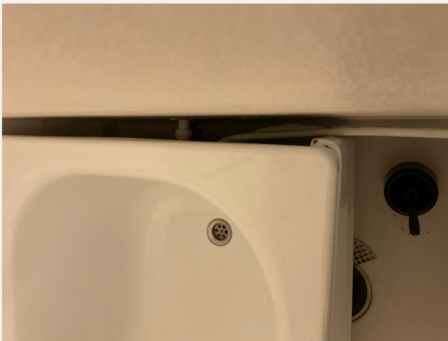
U5 VVS / Rödrugning - Inkommande tappvattenledningar (rör genomföringar) i plats för bad
