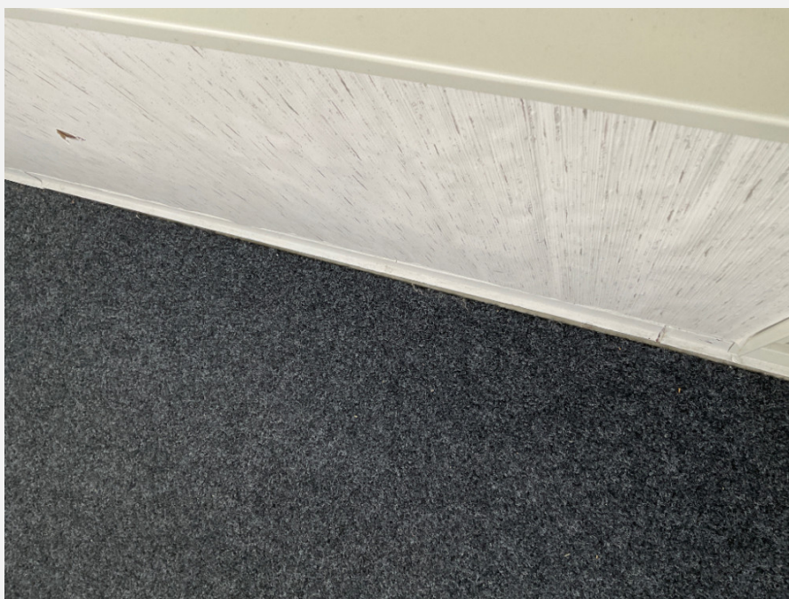
U2 Övrigt - Tapet i balkong, luftbubblor. Rekommenderas ej utomhus i icke uppvärmt utrymme
