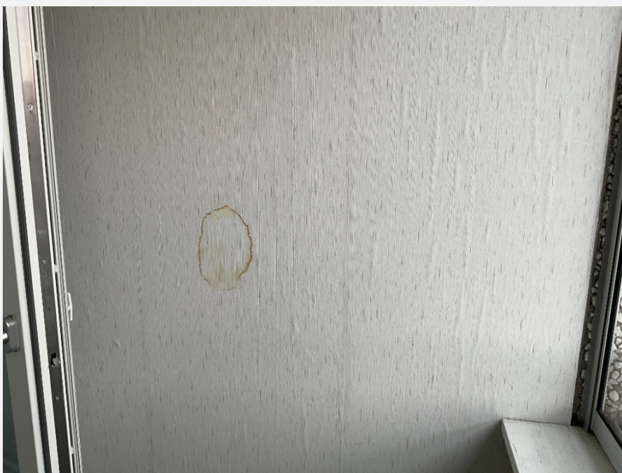
U2 Övrigt - Tapet i balkong, luftbubblor. Rekommenderas ej utomhus i icke uppvärmt utrymme
