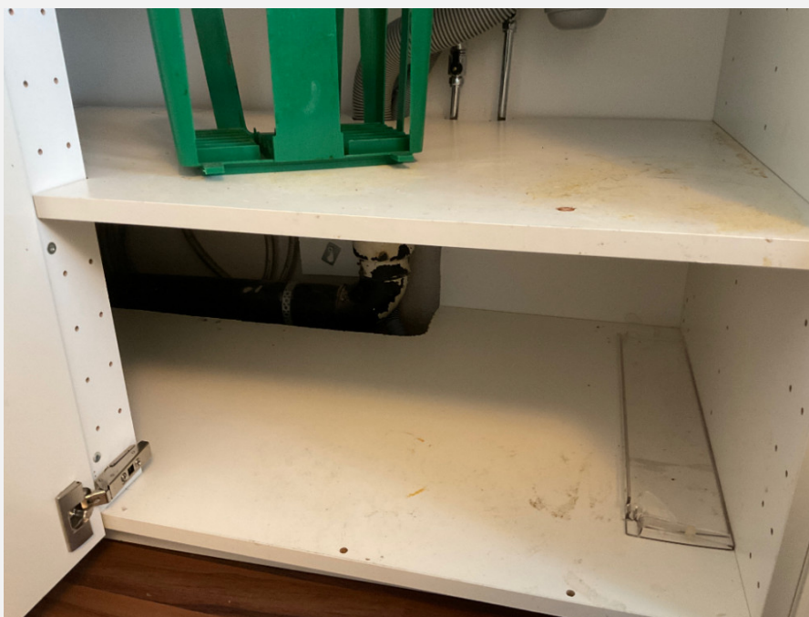
U3 Övrigt - Fogar på tappvattenledningar i diskbänk är placerade ovan underlag utan vattentätt golv.
