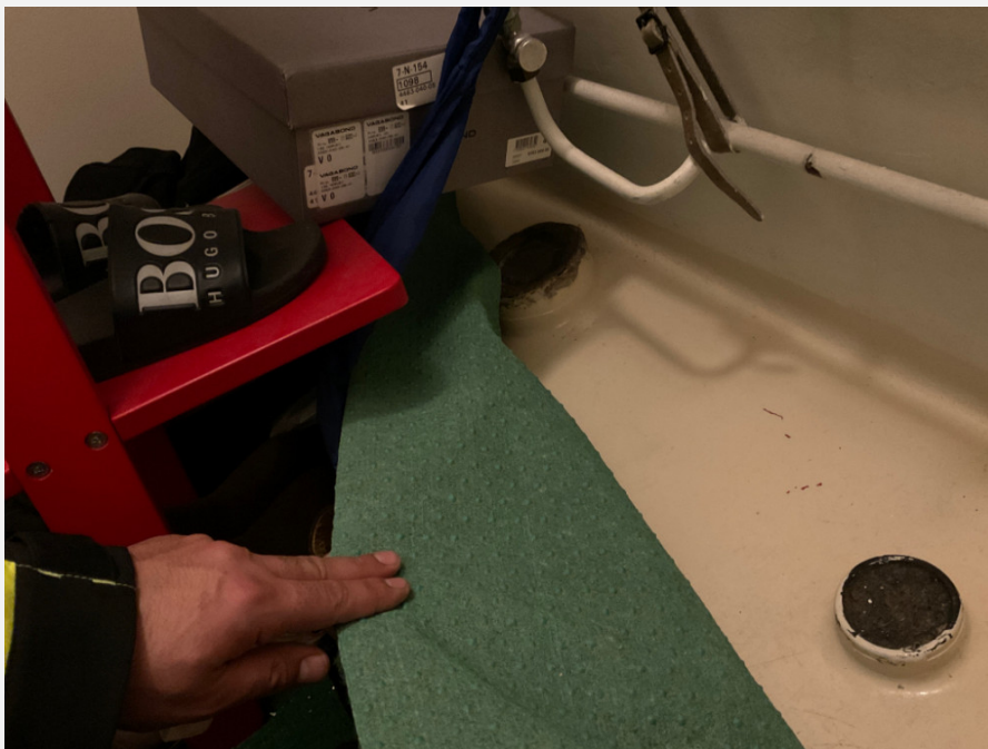
E1 Övrigt - Avsättningar spillvatten i förråd (fd. wc) behöver proppas korrekt
