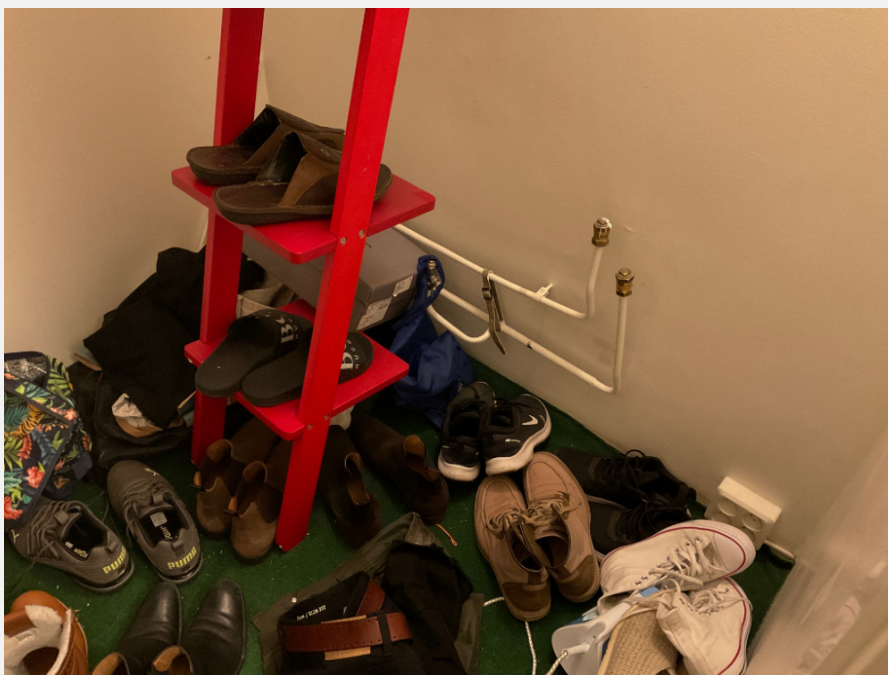
E2 VVS / Rördragning - Outnyttjad blindledning på kall- och varmvatten i förråd. Risk för stillastående vatten med legionella tillväxt som följd
