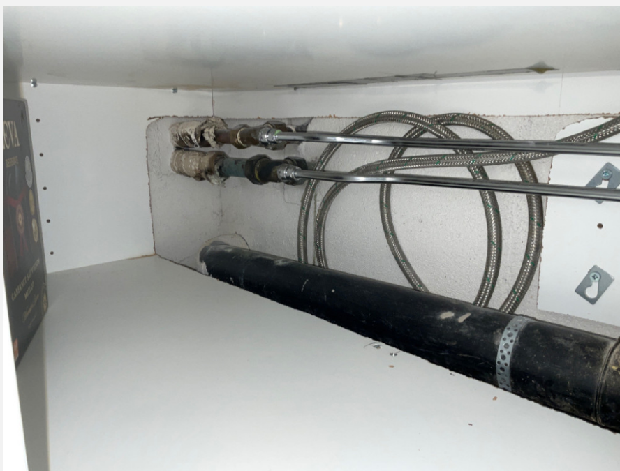
U4 Övrigt - Tappvattenledningar tjänar våtrum med synliga kopplingar i diskbänkskåp. Detta behöver åtgärdas när kök eller våtrum renoveras. Under kopplingarna behöver slitsbotten installeras med läckageindikering som mynnar in mot våtrummet.
