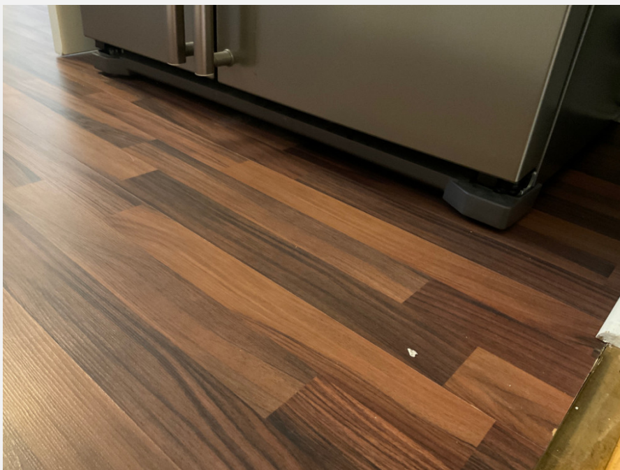
U7 Övrigt - Läckageskydd saknas under kyl/frys
