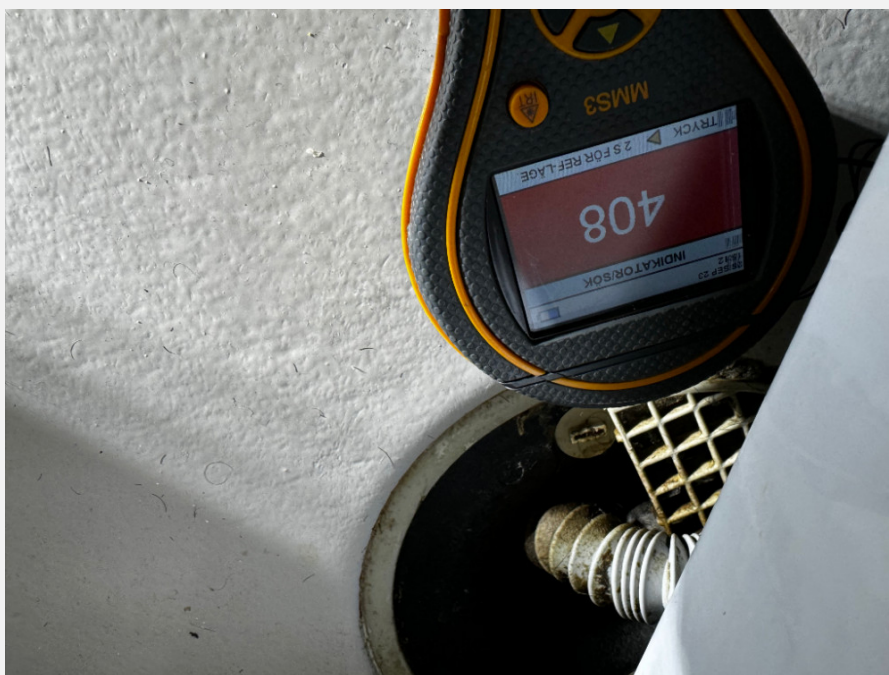
U1 Övrigt - Förhöjda fuktvärden på golv - läs övriga noteringar
