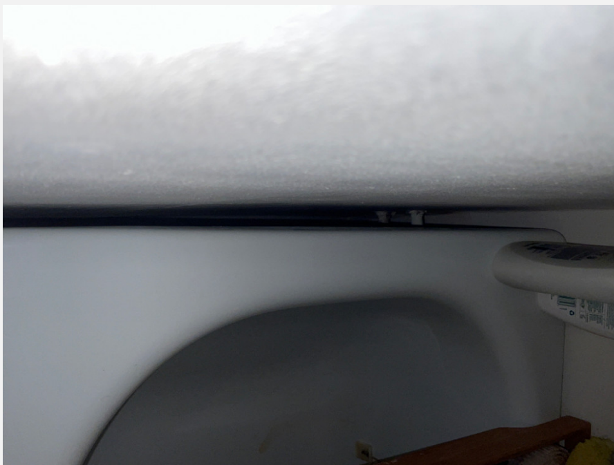
U5 VVS / Rödrugning - Inkommande tappvattenledningar (rör genomföringar) i plats för bad
