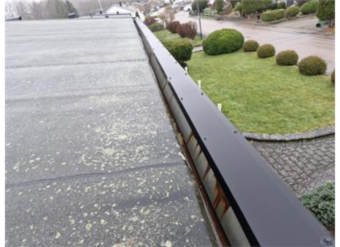
Rännor, inbyggda konstruktion, rostangrepp förekommer.
