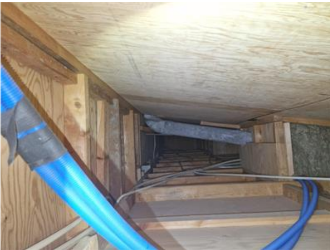
Vindsutrymme ovan Hall, ventilationsrör av eternit.
