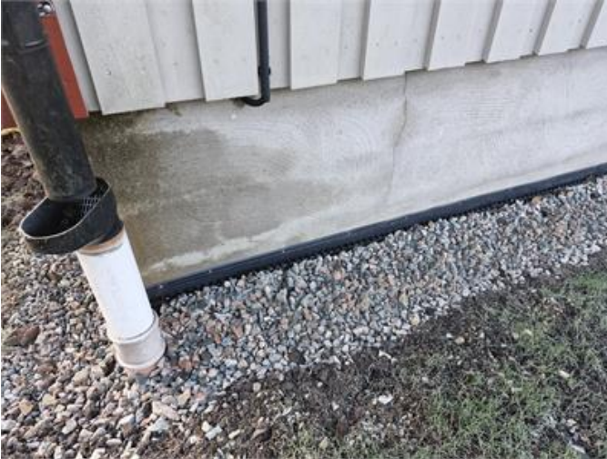
Sockel, enstaka sprickor noterades.
