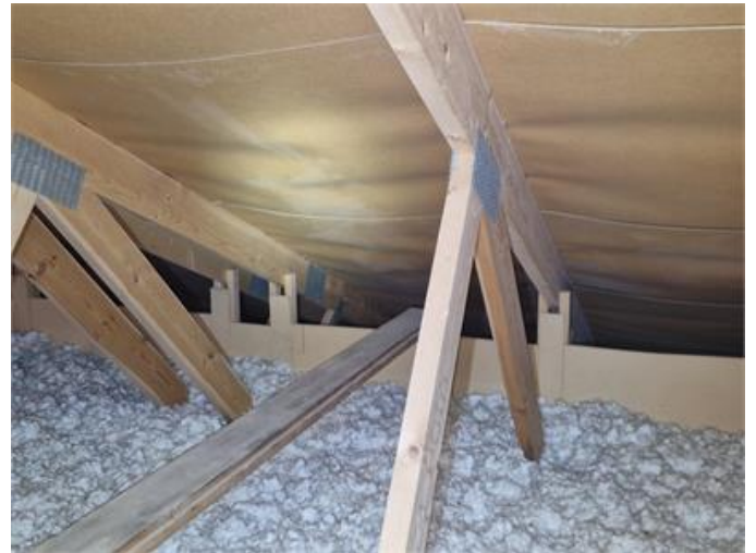
Nockvind, torra fuktanvisningar på undertaksskivor.
