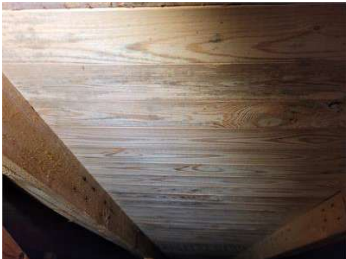
Mikrobiell påväxt på underlagstak
