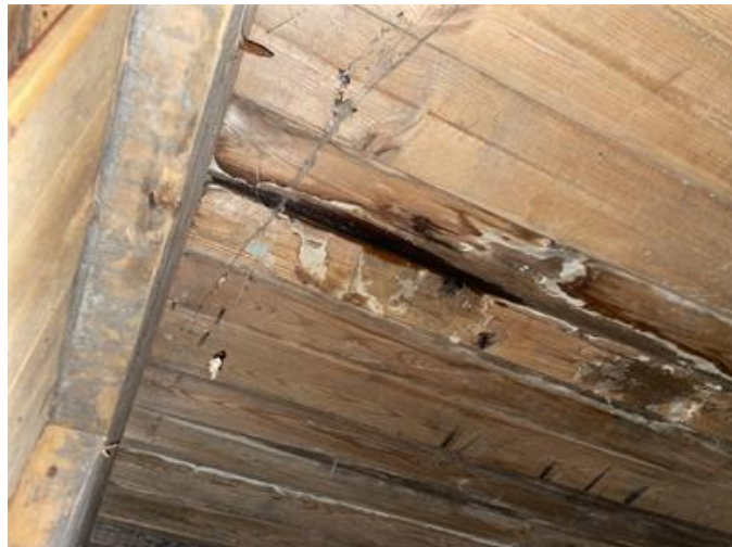
Vind med fuktgenomslag
