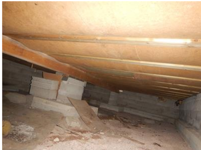
Mikrobiell påväxt på blindbotten i krypgrundsdel.
