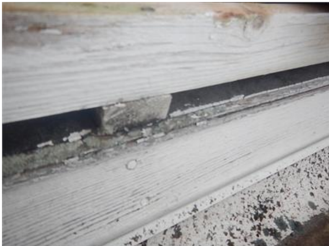
Takfotsplåt ej monterad.
