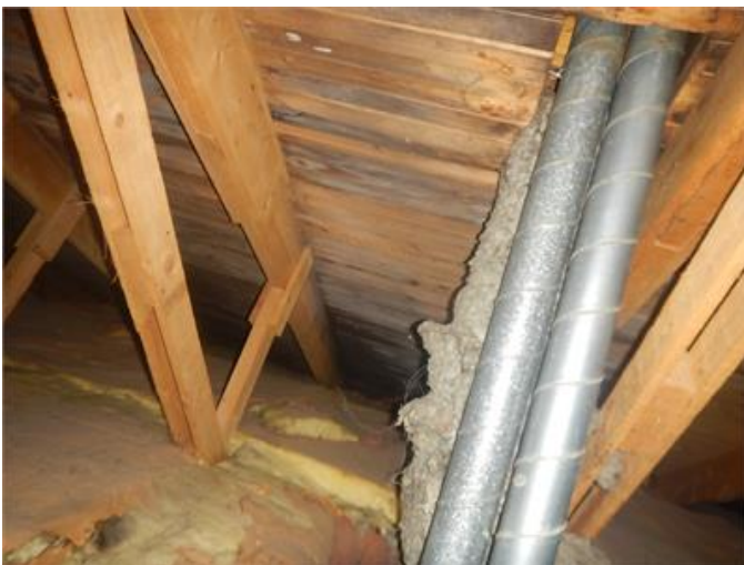
Oisolerade ventilationsrör på vind.
