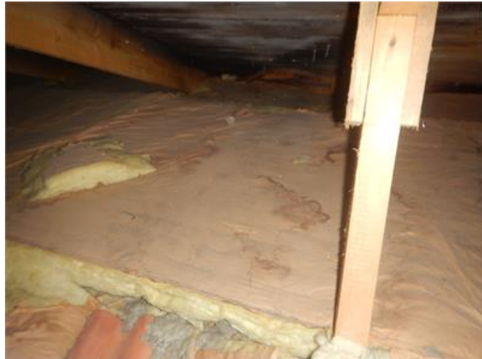
Fuktpåverkan på pappbeklädd isolering vind.
