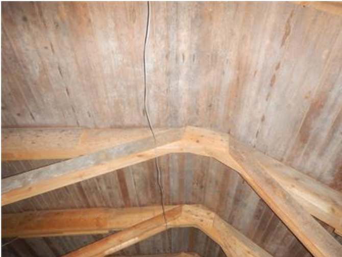
Mikrobiell påväxt på underlagstak vind.
