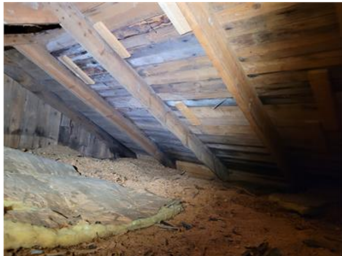
Mikrobiell påväxt på underlagstak
