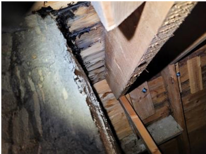
Läckage i yttertak invid murstock.
