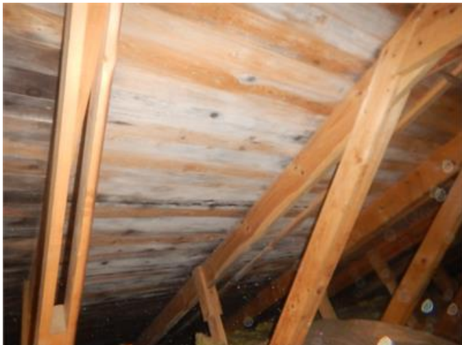
Mikrobiell påväxt på underlagstak vind.
