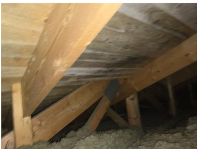
Exempel på mikrobiell påväxt på underlagstak.
