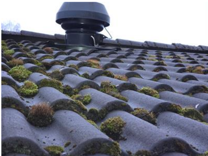
Exempel på yttertak med mossa och otätheter kring plåthuv/fläkt.
