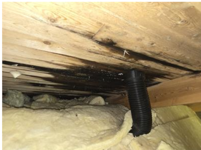
Exempel på fuktgenomslag/läckage kring avloppsluftare.
