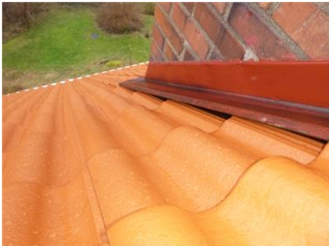
Kort överlapp mellan skorstensplåt och takpannor
