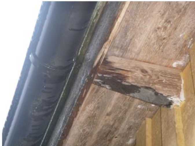
Läckage i takfot mot garagets baksida
