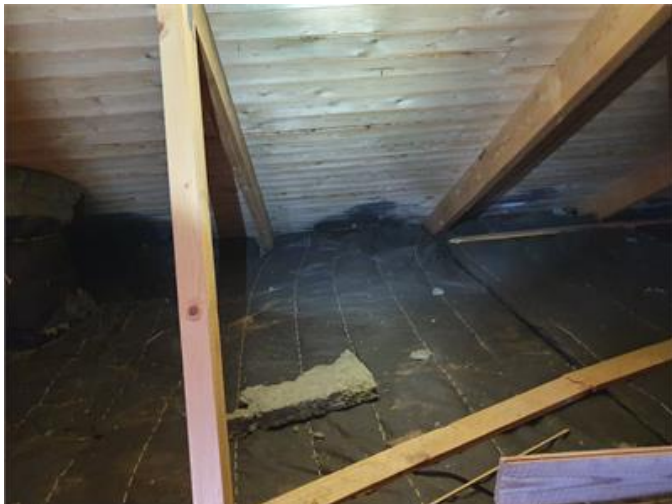
Utrymmet på vinden med mikrobiell påväxt
