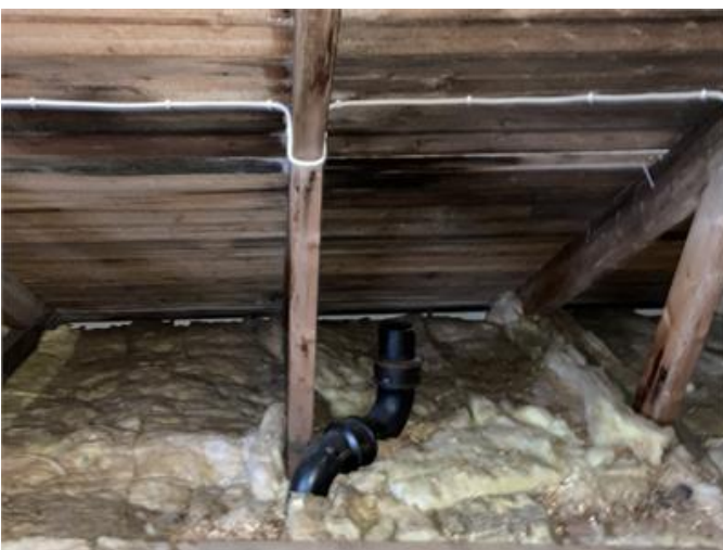
Mikrobiell påväxt förekommer lokalt och oregelbundet på underlagstak vind 2. Avloppsventilation mynnar på vinden.
