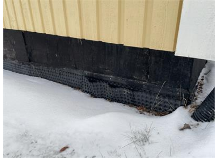
Delar av utvändigt fuktskydd är bristfälligt.
