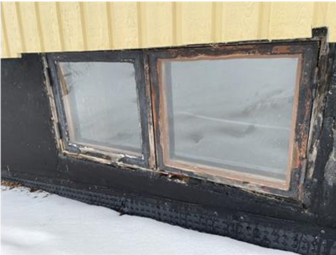
Äldre fönster har underhållsbehov och något är ev. i behov av byte.
