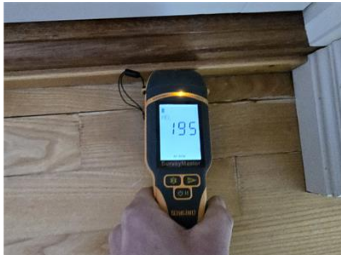
Formförändring parkett vid balkongdörr.
