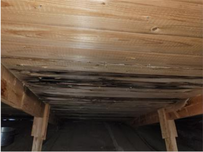
Fuktfläckar på underlagstak.
